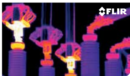
Image thermique d'une sous-station présentant un transformateur dont la température est trop élevée.
